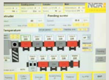
Pannello di controllo
